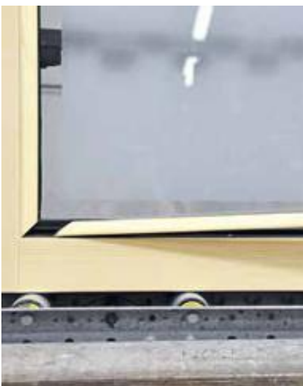
7. Schritt: Setzen Sie die Glasleiste ein, die entsprechend gefräst und zugeschnitten ist.
