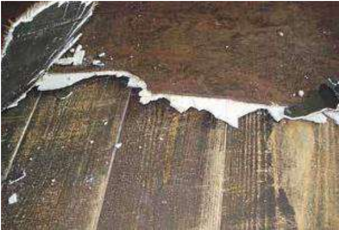
Die Gipspachtelmasse hat sich vom neu eingebauten Dielenboden gelöst.
