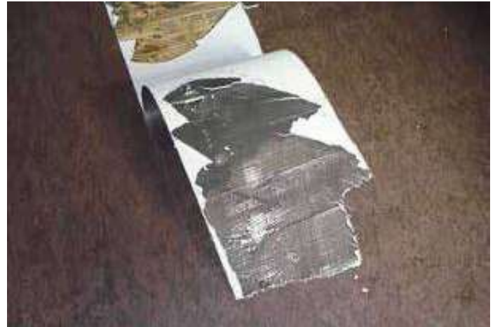
Der Linoleumbelag hat sich vom Dielenboden gelöst.
