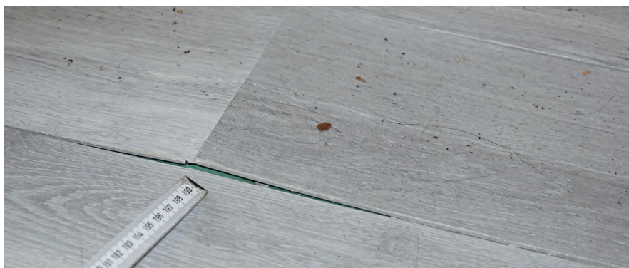
Häufige Schäden bei LVT mit Klickverbindung: Aufschüsselung ...
