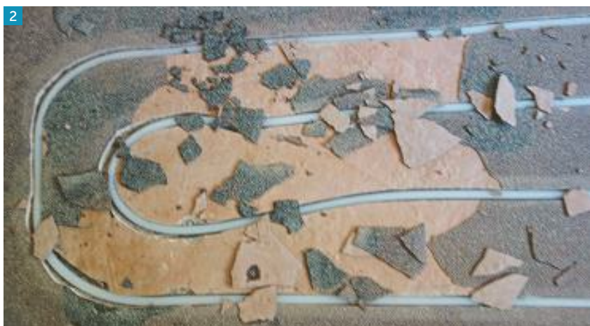
2 Abgeplatzte Reaktionsharzgrundierung aufgrund nicht fachgerechter Untergrundvorbereitung.
