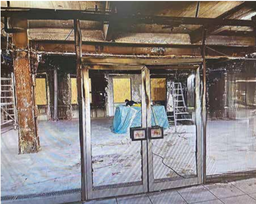
Die Ladenräume der Textilreinigung nach dem Brand. Zerstörte Textilien und kaputte Maschinen wurden bereits entfernt.
