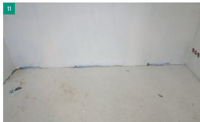
Zum Vergleich: ein nicht fachgerecht eingebauter Randdämmstreifen.
