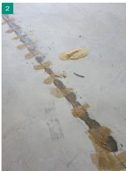
Kraftschlüssig verharzte Scheinfugen.
