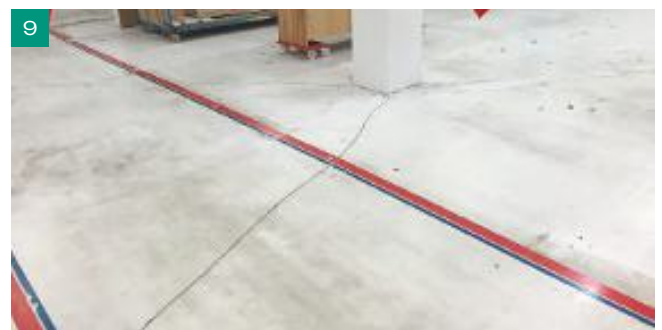
Dieser Riss bildete sich aufgrund einer fehlenden Bewegungsfuge.
