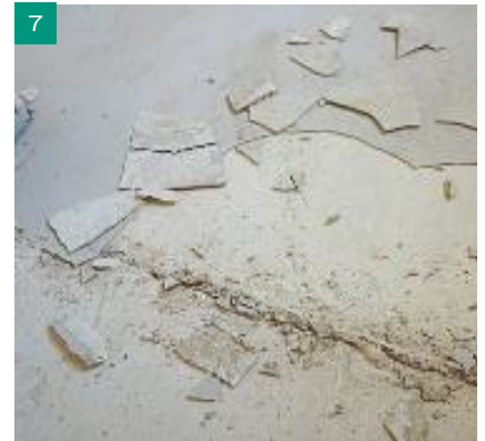
Eine abgeplatzte Spachtelmasse über einer Bewegungsfuge.
