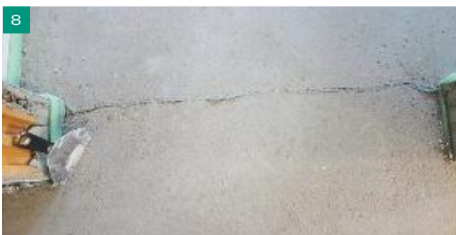
Eine nicht fachgerecht ausgebildete Bewegungsfuge.
