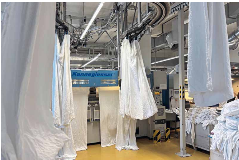
Alle Trocknungsmaschinen (wie Mangeln) werden in der Wäscherei der Uniklinik Freiburg nun mit 4 bar Dampfüberdruck beheizt.
