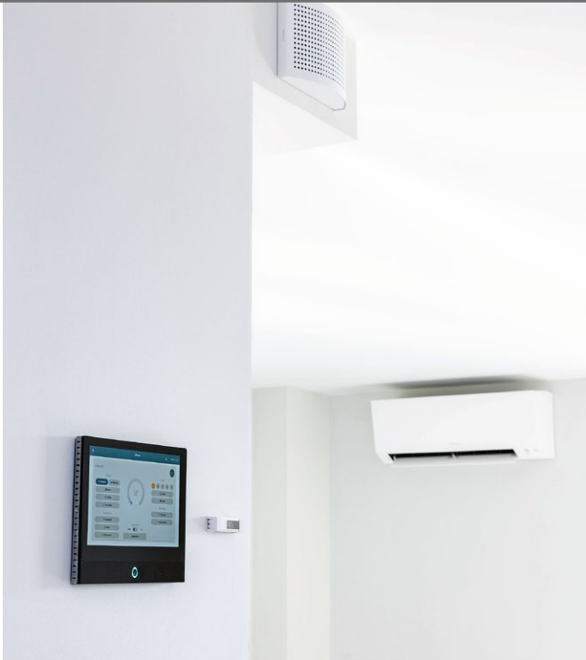
Inneneinheit rechts oben und das Bedientableau für die Luft-/Luft-Wärmepumpe.
