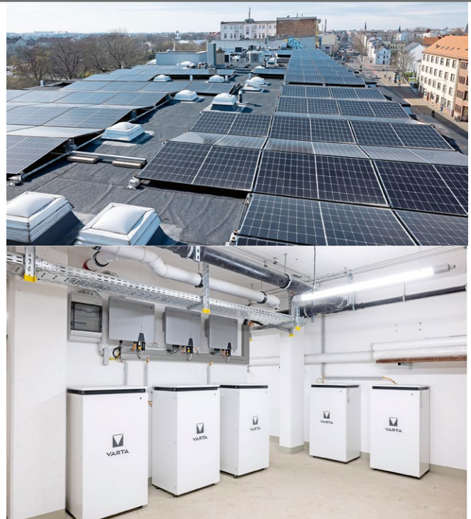
Die Einbindung von Photovoltaik und Batteriespeichern gehört zum Gesamtkonzept.
