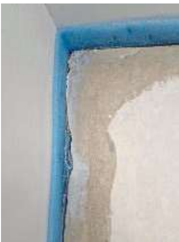
Perfekte Ausführung des Randdämmstreifenstreifens. Der Streifen ist dicht anliegend bis in die Ecke geführt.
