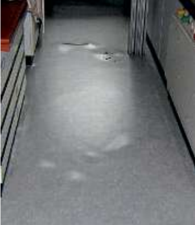
Blasen und Beulen im elastischen Belag aufgrund nicht fachgerechter Verlegung.
