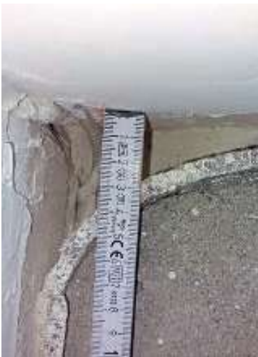
Der Randdämmstreifen ist nicht bis in die Ecke geführt, sondern rund, weil es schneller geht, um die Ecke gezogen.
