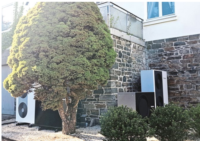
Monitoring für Weiterentwicklungen: Vor dem Wohn- und Schulungsgebäude testet Peter Brecklinghaus vier unterschiedliche Luft-/Wasser-Wärmepumpen.
