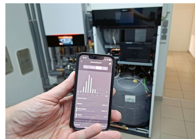
Die Heizungs-App zeigt 70 bis 90 % Gaseinsparung an. Der Gaskessel kann später auch auf Wasserstoff umgerüstet werden.
