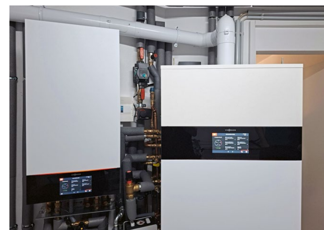
Gas-Kombikessel bei Fam. Klein in Betzdorf: Das HHS-Hybrid-System, welches auf den Kessel moniert werden kann, verbindet mit der neuen Wärmepumpe.
