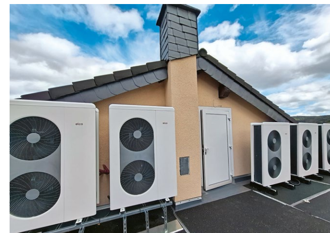
Neue Wärmepumpen auf dem Dach eines 29-Familien-Wohnhauses in Siegen, die über das HHS-Hybrid-System mit dem vorhandenen Gaskessel verbunden sind. Statt 295.000 kWh Gas werden nur noch 65.000 im Jahr verbraucht.
