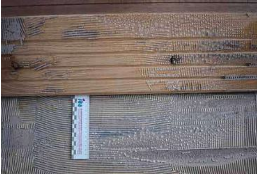
Bei Bauteilöffnungen zeigt sich an der Rückseite des Parketts eine zu geringe Benetzung mit Klebstoff...
