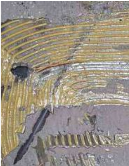
...sowie eine zu geringe Überdeckung der Heizrohre mit der Spachtelung.
