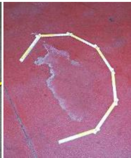
Bodenbeschichtung mit Ausblühungen und Flecken.
