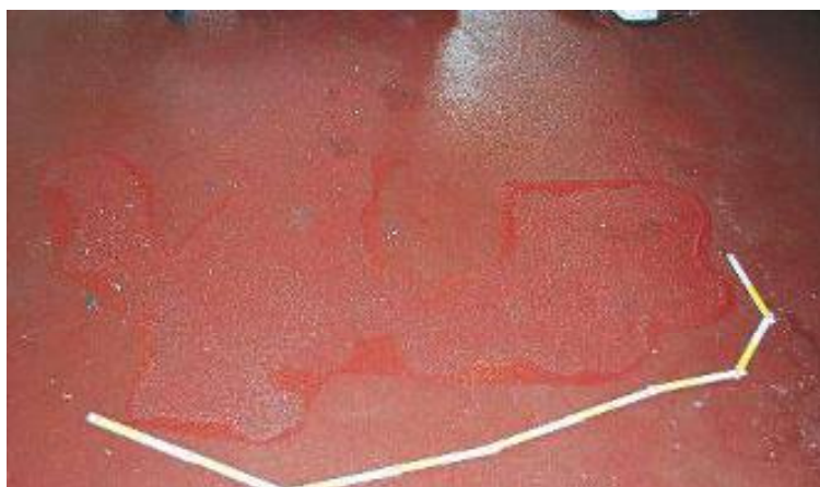
Bodenbeschichtung mit Ausbesserungsstellen
