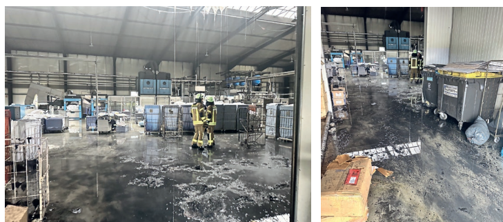
Auch Löschwasser kann Schäden verursachen.
